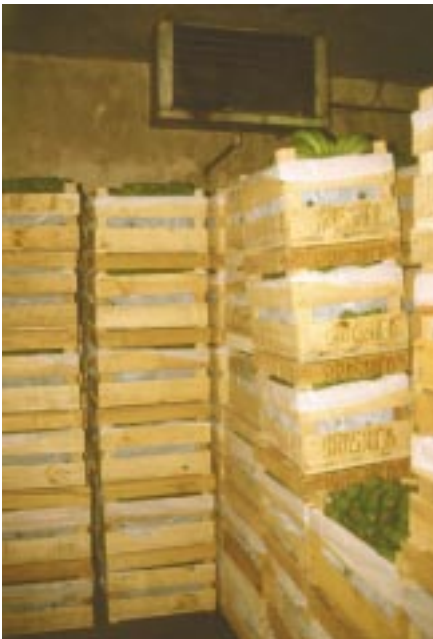
Câmara de amadurecimento e armazenamento de bananas.
