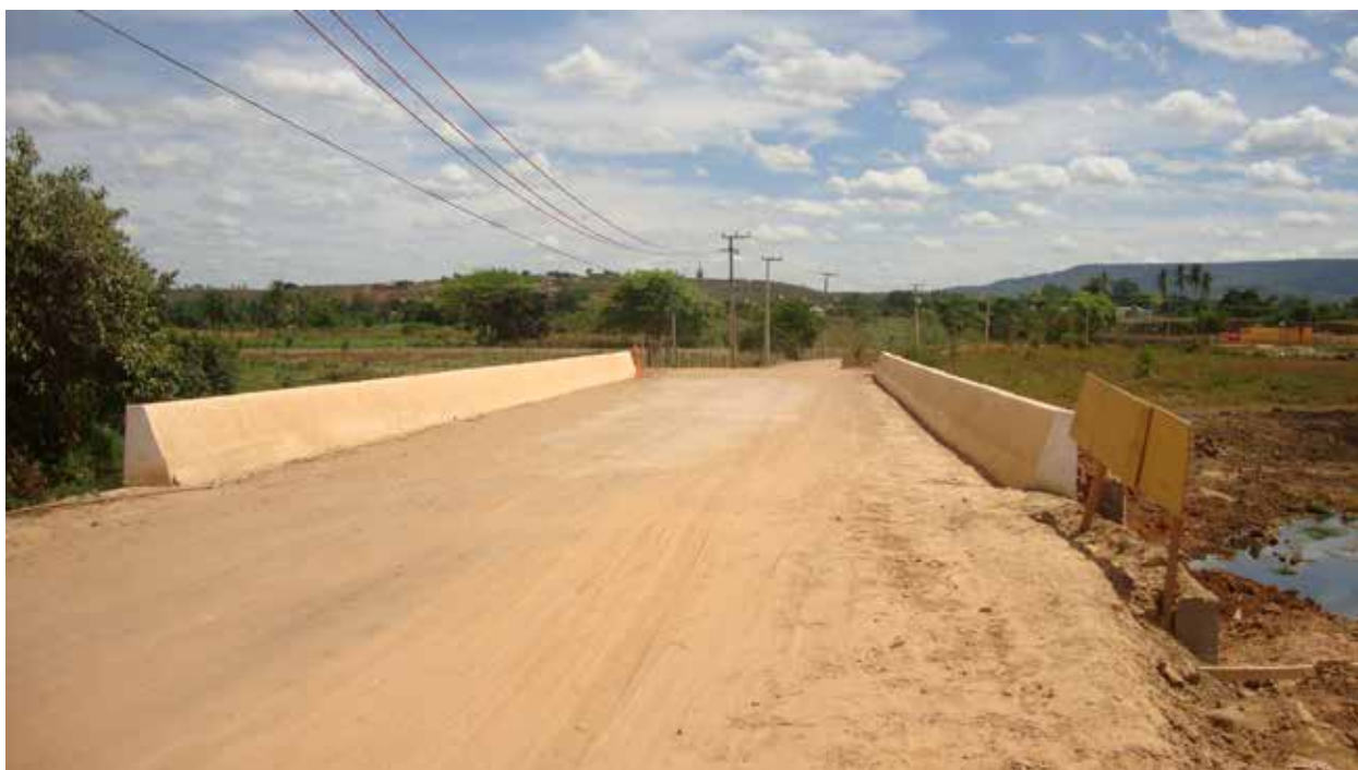
Figura 7. Ponte reconstruída sobre o rio Batateira, no ano de 2014. Crato/CE Fonte: SEDEC/MI.
